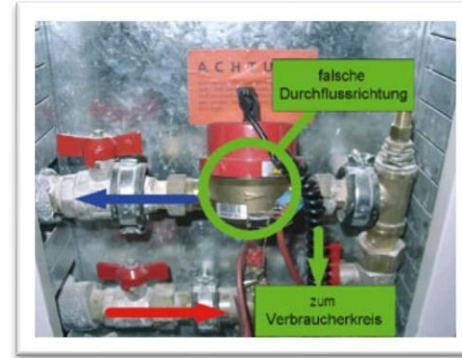
Volumenmessteil in falscher Fließrichtung
