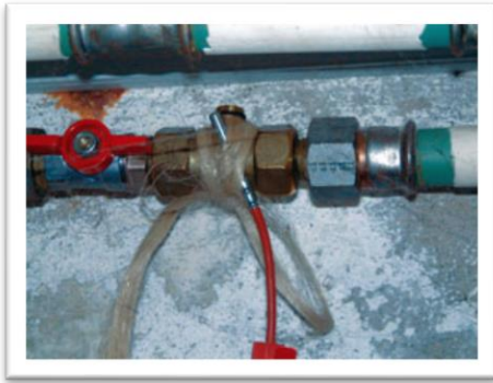
Temperaturfühler außen angebracht: Messung unbrauchbar
